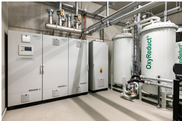
Bildunterschrift: Eine OxyReduct® Anlage zur Sauerstoffreduktion schützt automatisierte Behälterkompaktlager vor Brandentstehung bzw. -ausbreitung. Bildnachweis: ©WAGNER Group GmbH
