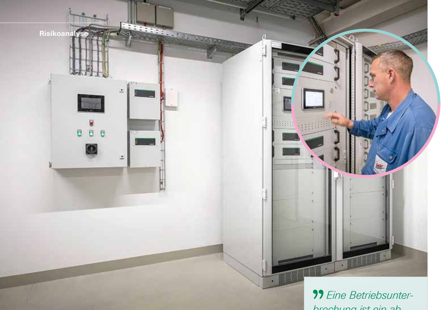
▲ Brennt für den Brandschutz: Sebastian Stoll, Technischer Mitarbeiter von Eisbär Eis, bedient die Steuerzentrale OxyControl.
