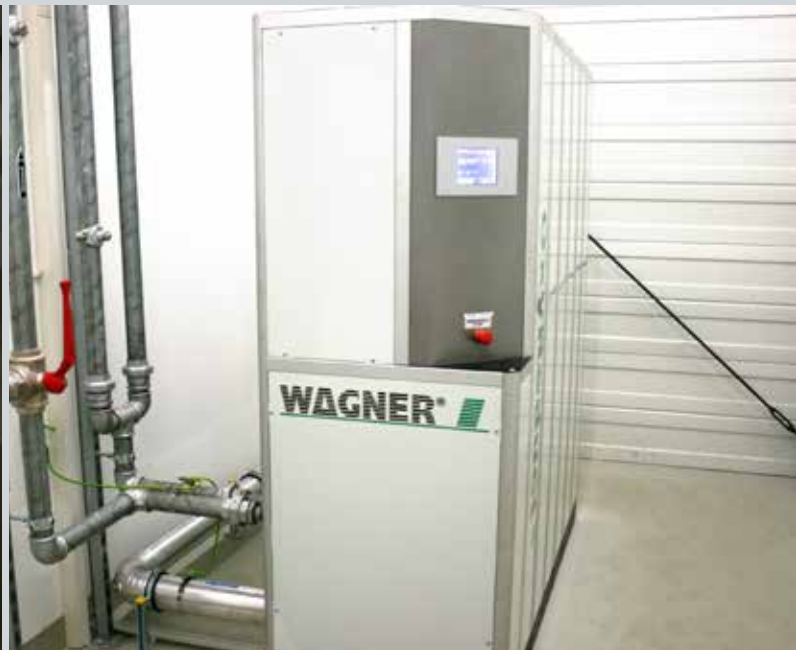
Die OxyReduct®-Brandvermeidungsanlage hält die Sauerstoffkonzentration im Lager konstant auf 13,5 Vol.-%
