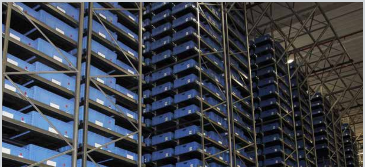
Das vollautomatische Hochregallager mit Kleinladungsträgern wird vor Brandgefahren mittels Ansaugrauchmeldesystem sowie aktiver Brandvermeidung geschützt.
