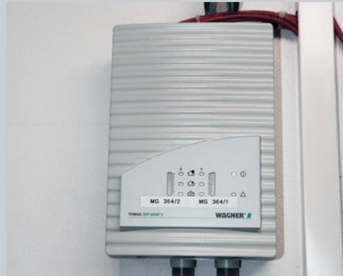
TITANUS® Ansaugrauchmelder wurden zur Überwachung des Rechenzentrums installiert
